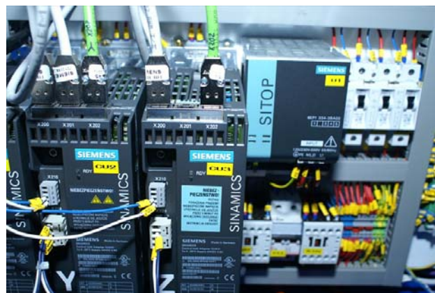
Rys.4.Przykład montażu napędów Sinamics S120 Blocksize w szafie sterowniczej.
